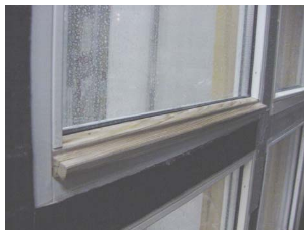
Figur 10. Revner i bundglasliste
