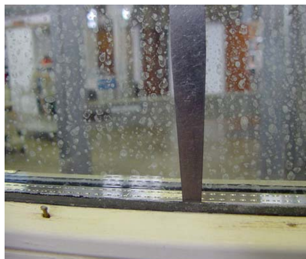
Figur 12. Slip mellem glasisætnings-bånd og rude i ukorrekt monteret
