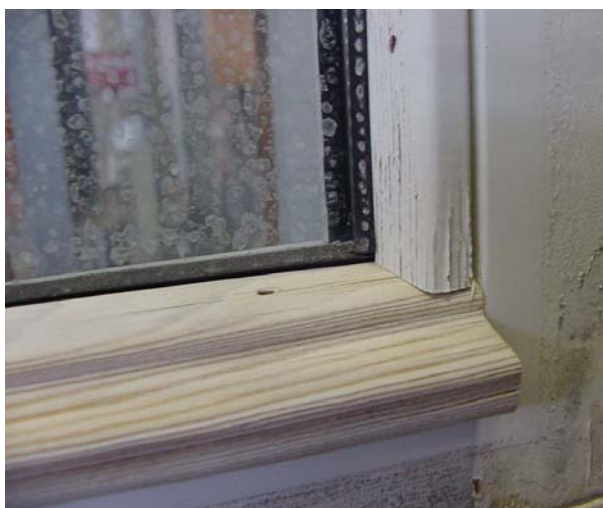
Figur 11. Revner i malingen på glaslisterne
