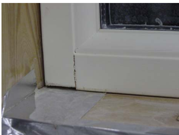
Figur 9. Udpresning af bundstykke ved ukorrekt rudemontering
